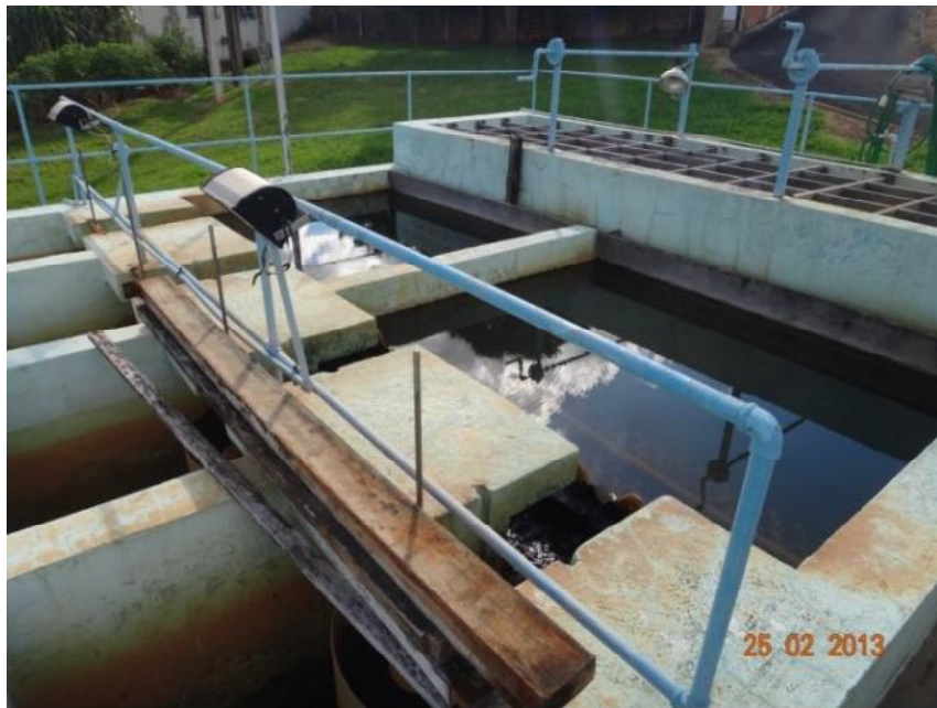
Foto 25: ETA - Floculador, Decantador e Filtros.
