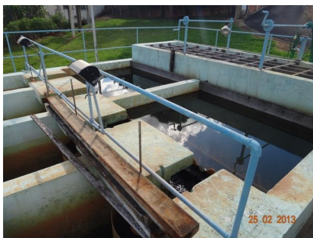
Foto 4.3 - ETA - Floculador, Decantador e Filtros.
