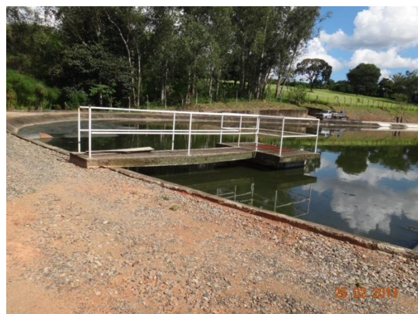
Foto 4.10 - Saída do esgoto tratado - Lagoa Facultativa
