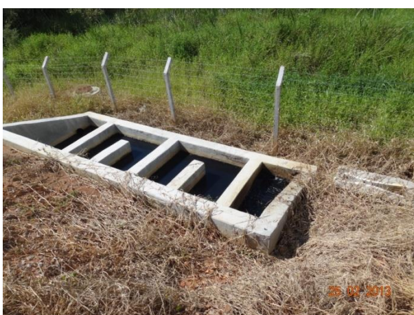
Foto 4.11 - Tanque de contato (não é realizada a desinfecção)
