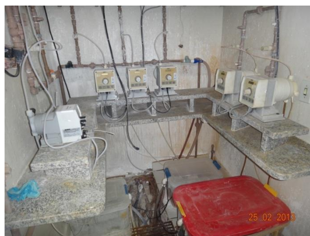
Foto 4.4 - ETA I - Dosadores.
