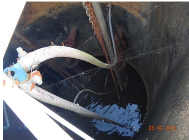
Foto 4.2- Poço de Sucção - EEAB1.
